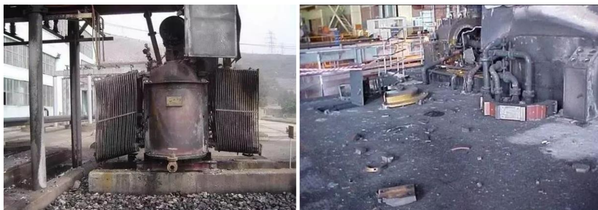
图 1-2 发电厂生产安全事故现场照片
