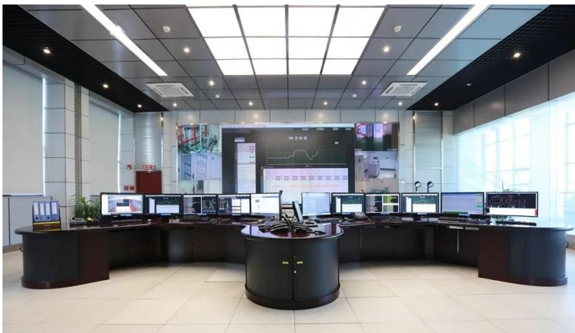
图 1-5 华能糯扎渡水电站集控室“无人值班”现场
