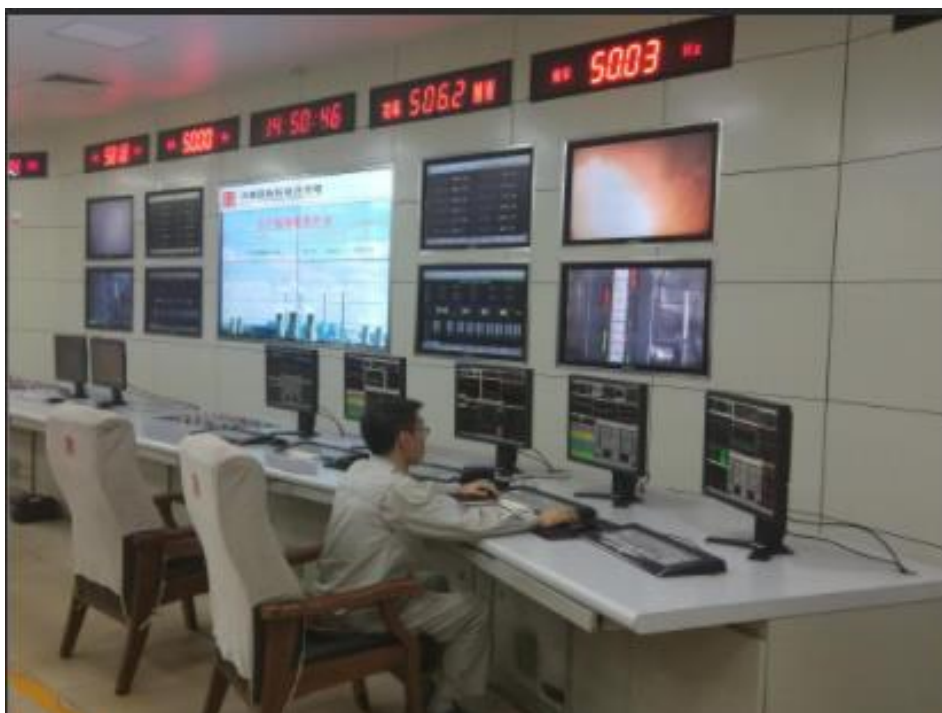
图 1-3 发电厂集控室现场照片
